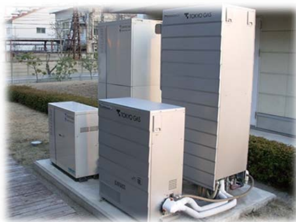
شکل (۱۲): نمونه ای از سیستم‌های SOFC نصب شده در ژاپن تحت پروژه ENEfarm
